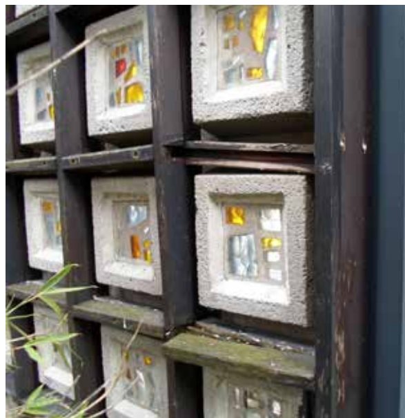
Abb. 6 Schäden am Holzraster im Kapellenumgang
