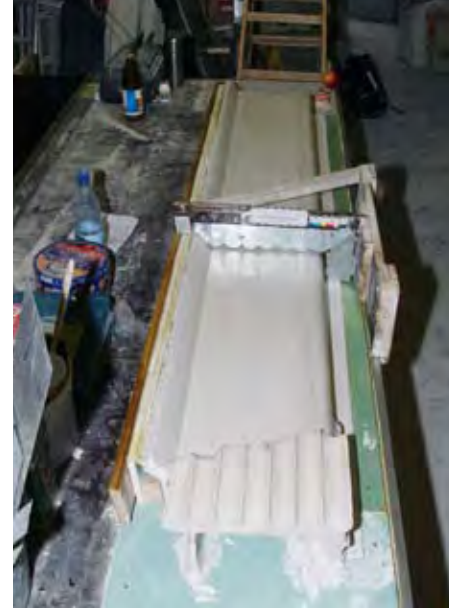
▲ Herstellung eines Pilasters als Tischzug. Im Bildvordergrund ein abgeformtes Originalteil in Gips ausgegossen. Gegen die Bruchkante wird gezogen. Nach dem Aushärten des gezogenen Pilasters wird der Gipsausguss entfernt, und der neue Marble-Cement-Pilaster kann später wie ein Inlet in die Altsubstanz eingefügt werden.
