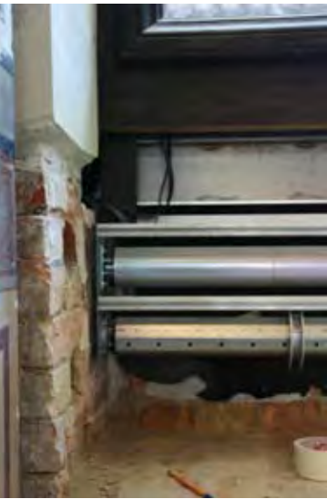
▲ Mechanische Verschattungsanlage unterhalb der Drillingsfenster im Bacchusaal
