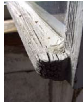
▼ Fenster vor der Restaurierung stark ausgewittert
